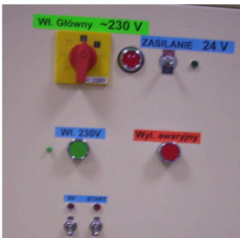
Rys. 16. Widok panelu zasilania
